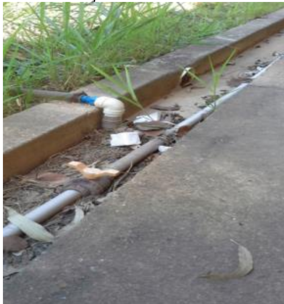
Figura 7 - Tubulação consertada e sem vazamento
