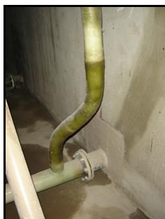
Figura 7. Tubulações de escoamento da espuma
