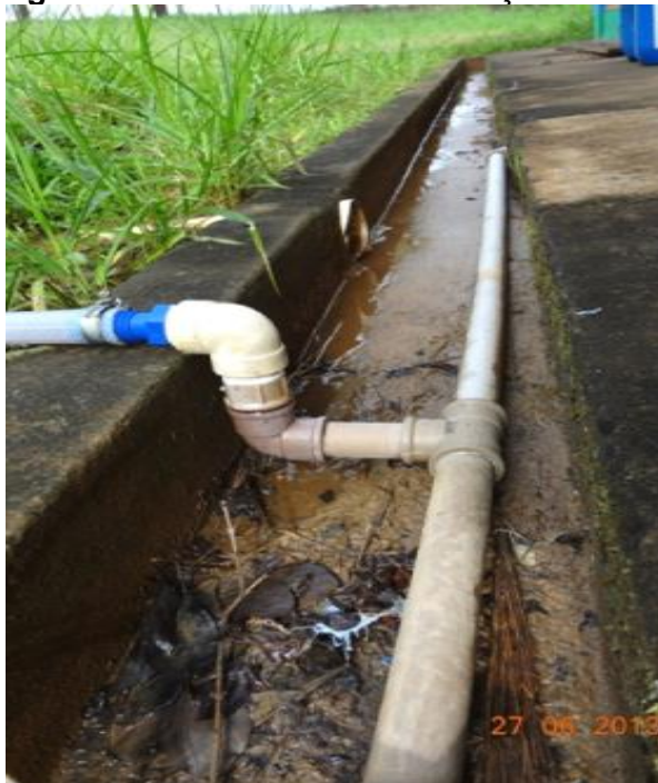
Figura 6 - Vazamento em Tubulação da ETA
