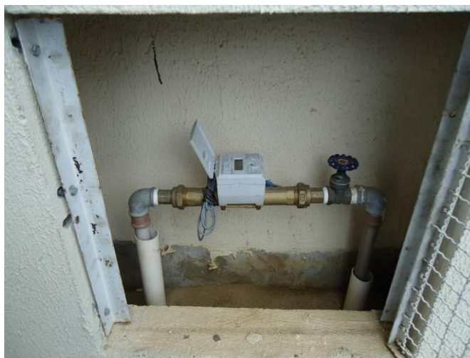
Figura 02 - Medidor Ultrassônico de 1” instalado em um grande consumidor
