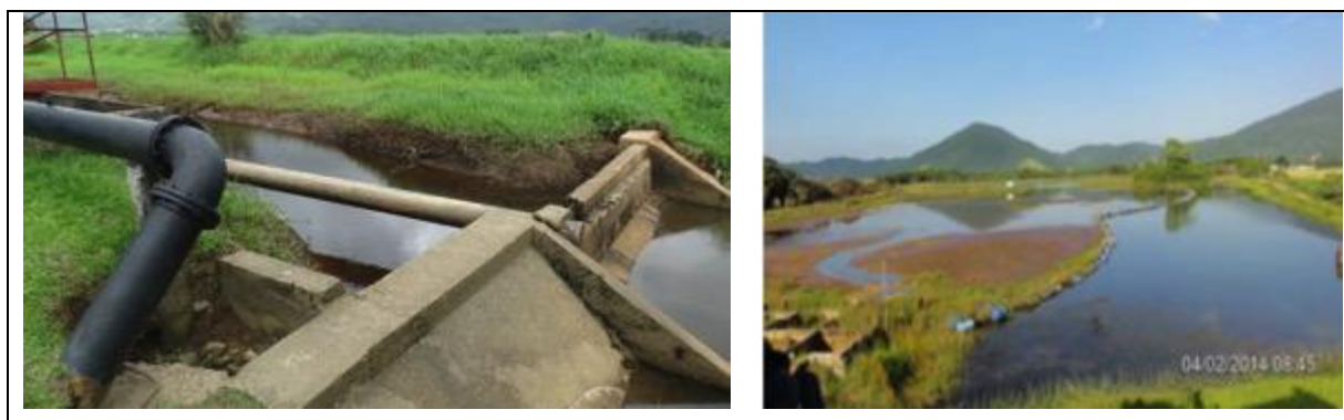
Figura 3 - Nível crítico na tomada de água da captação e da lagoa de acumulação da CASAN em Porto Belo
