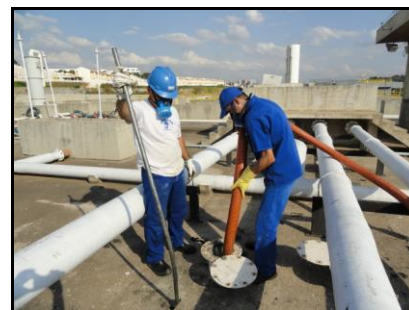
Figura 11. Tentativa da remoção da espuma – esgota fossa
