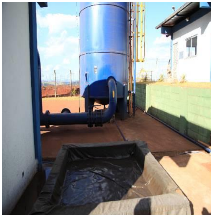
Figura 4 – Sistema de secagem de lodo.
