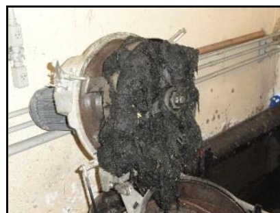
Figura 17. Triturador aberto para inspeção/limpeza
