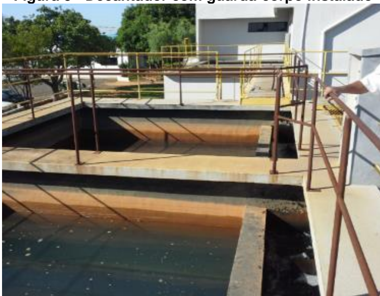
Figura 5 - Decantador com guarda-corpo instalado
