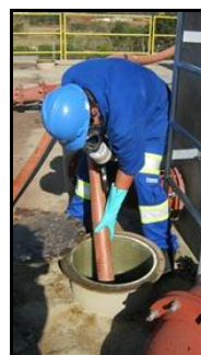
Figura 2. Limpeza da espuma com esgota fossa
