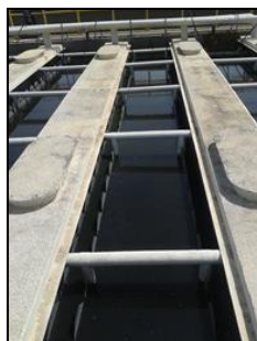
Figura 3. Vista superior UASB. Compartimento decantação e separador trifásico
