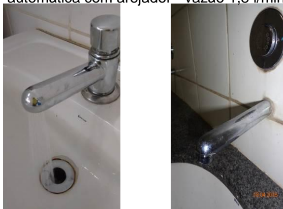
Foto 10 – Torneira de bebedouro automática com arejador - vazão 1,8 l/min.
