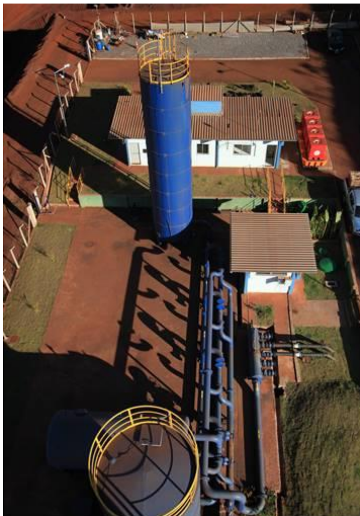
Figura 2 – Unidade de Tratamento de Água (UTA)
