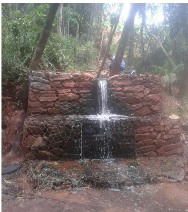
Figura 13 - Ponto de lançamento e monitoramento do efluente tratado.
