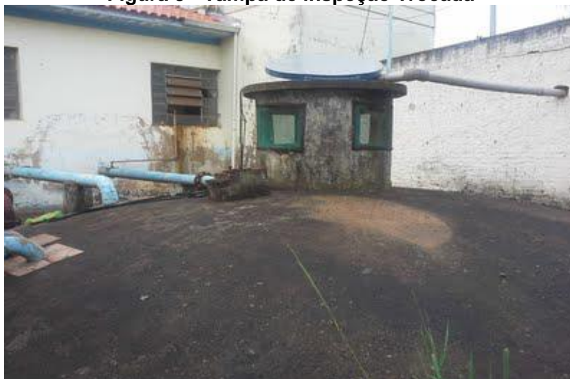
Figura 3 - Tampa de Inspeção Trocada
