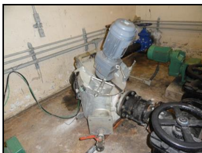
Figura 15. Triturador de resíduos – ETE Anhumas
