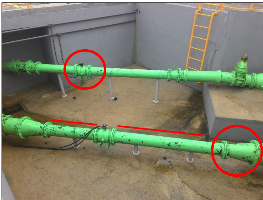
Figura 01 – Macromedidores eletromagnéticos no recalque da saída da ETA Central dos reservatórios R2 e R4 respeitando trecho reto a montante e a jusante e redução de diâmetro
