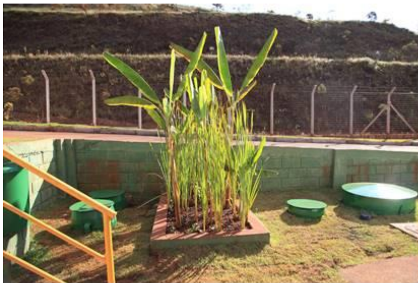
Figura 5 – Sistema piloto de tratamento de esgoto.
