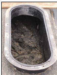
Figura 4. Tampa do separador aberta para limpeza – espuma
