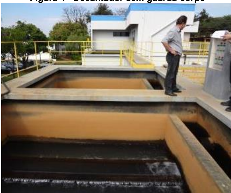
Figura 4 - Decantador sem guarda-corpo
