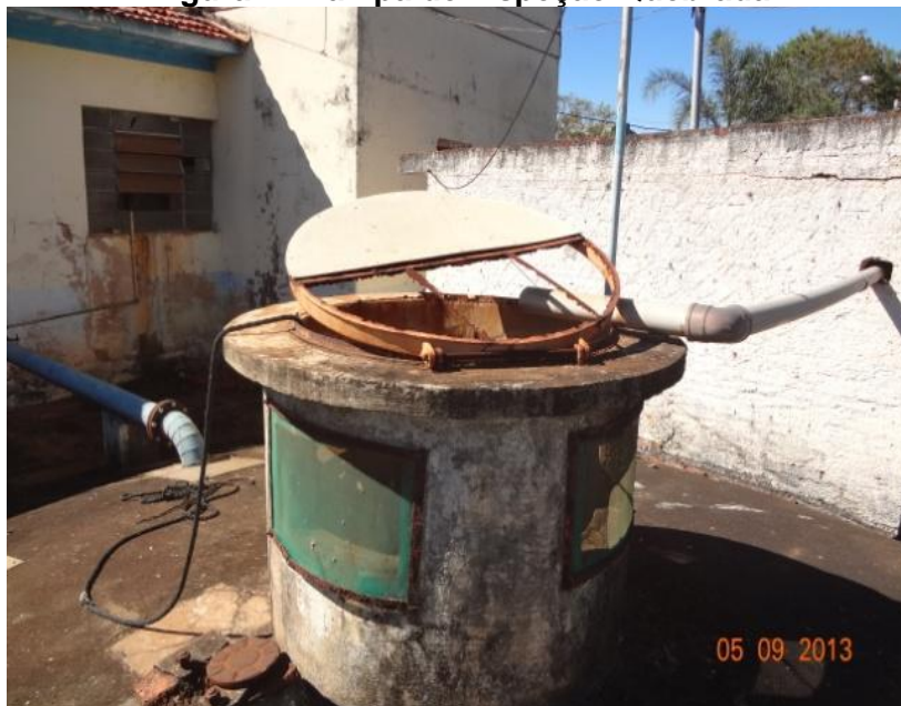
Figura 2 - Tampa de Inspeção Quebrada
